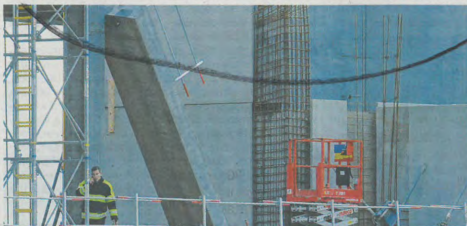
La passerelle en béton armé qui s'est effondrée a tué un ouvrier et en a blessé grièvement un autre.
